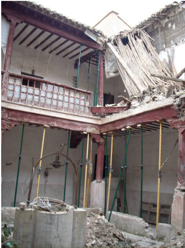
Figura 10. Esquina sur del patio antes de que colapsase por completo el corredor suroeste, en la derecha de la foto (Ayuntamiento de Cehegín).
